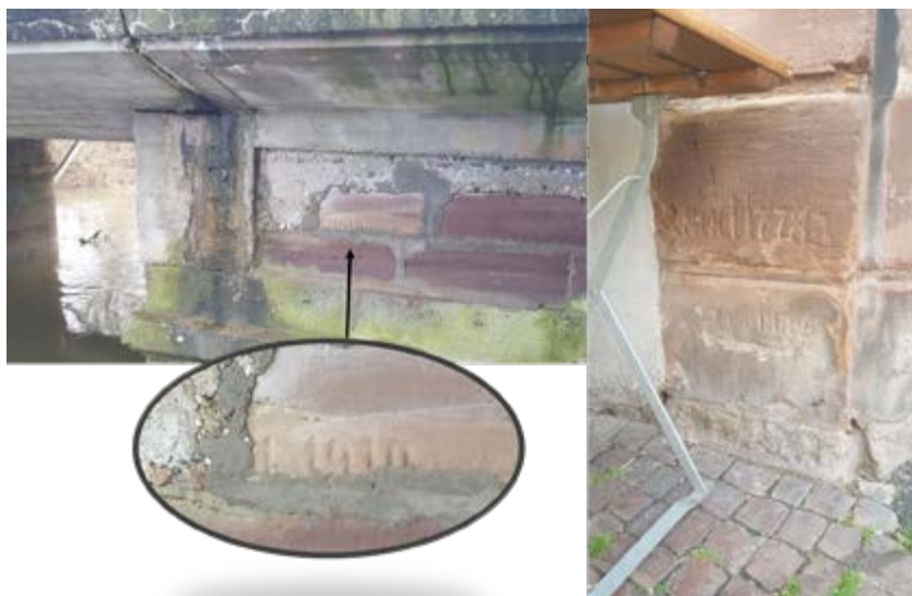
Fig. 7 : Altération et dégradation des repères de crues 57
